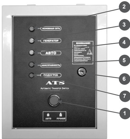
Рис. 14 Контрольная панель блока ATS
